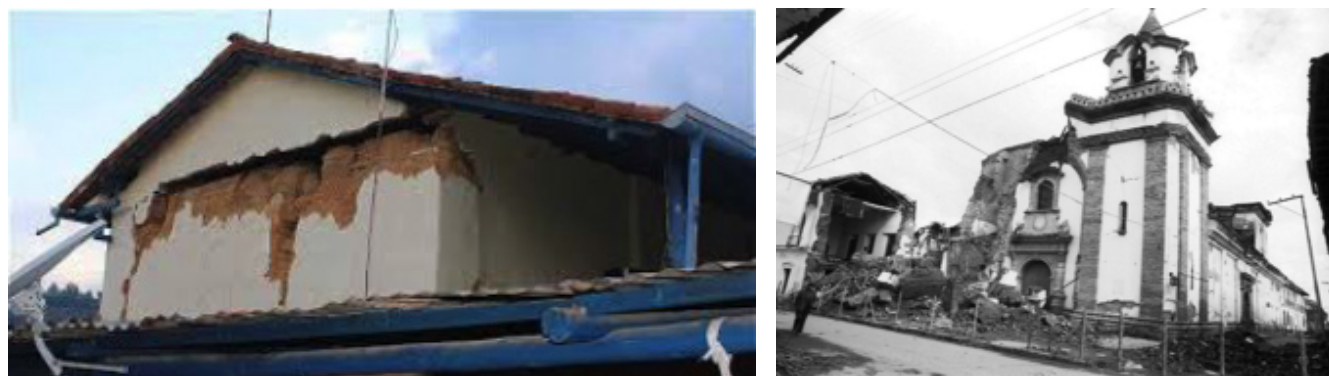
Fig. 2 – Algunas fallas en estructuras de tierra. a) Falla de un muro de una vivienda en el municipio de Betulia durante el Sismo de los Santos (10/03/2015). Fuente: José Manuel Prada [4]. b) Colapso parcial de una Iglesia en Popayán durante el sismo del 31 de marzo de 1983. Fuente: [5]
